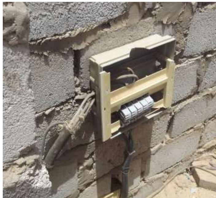
Figura 4. Acometida eléctrica más cercana.
